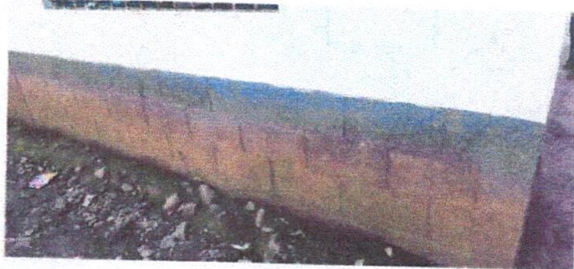
Foto 5: En las fotos se observan manchas oscuras, amarillentas o verdosas, típicas de filtraciones de agua o humedad capilar, lo que sugiere falta pintura.
