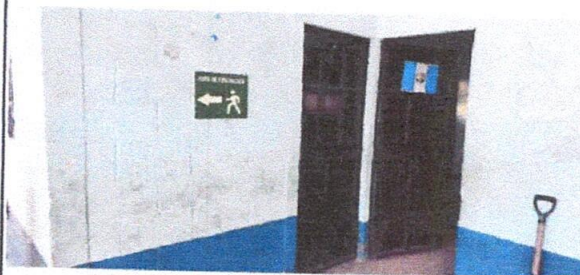
Foto 6: Las paredes están visiblemente manchadas con barro, lo cual no solo deteriora la estética, sino que también representa un problema de higiene que dificulta la limpieza adecuada.
