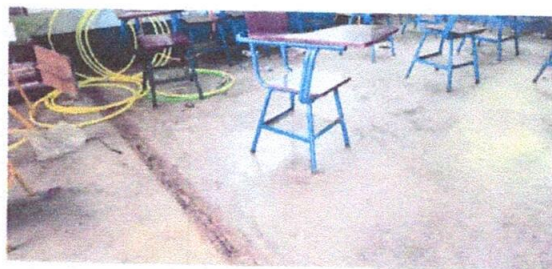
Foto 2: se observan grietas en el piso, algunas profundas, otras superficiales, que podrían comprometer la integridad estructural y dificultar la limpieza y el mantenimiento.
